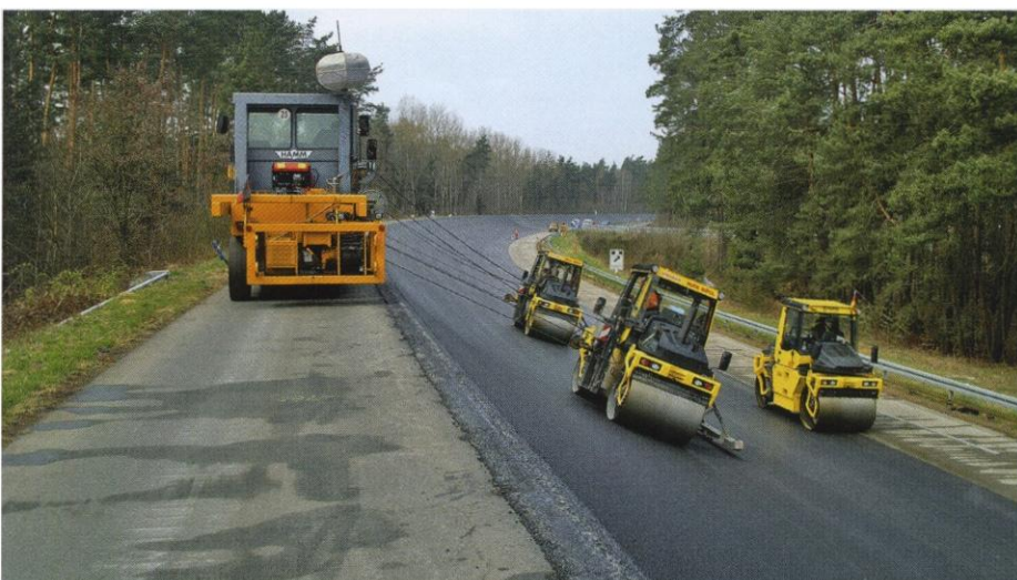
Bild 11: Um Walzspuren zu vermeiden, durften die Bandagenränder keinesfalls in den frisch verdichteten Asphalt eindrücken. Aus diesem Grund wurden die oberen Walzen mit einer Neigungssteuerung ausgerüstet. Ein Rechner in den Windenwagen steuerte den in der Höhe variablen Haltepunkt so, dass die Walzen immer orthogonal zur Oberfläche fahren
