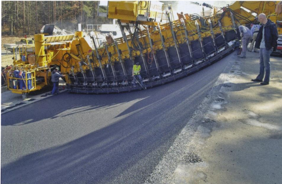
Bild 9: Der Brückenfertiger baut den Asphalt mit einer elektrisch beheizten Bohle ein. Sie besteht aus 17 einzelnen Körpern, die mit dem durchgehenden Bohlenblech verbunden sind. Insgesamt 17 Hydraulikzylinder steuern dabei die Verformung der Bohle
