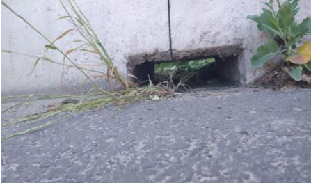
Bild 5: Zusedimentierte Öffnung am Fuß der Betonschutzwand mit angewachsenem Bankett (Blickrichtung von Seitenstreifen aus) (ISE, 2020)
