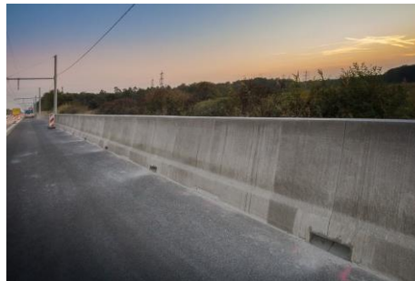
Bild 4: H4b-Fahrzeugrückhaltesystem entlang der ELISA-eHighway-Teststrecke (Foto: LineTech)
