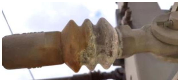
Abbildung 2: Isolatorenbeschädigung ELISA-Versuchsanlage (Siemens)
